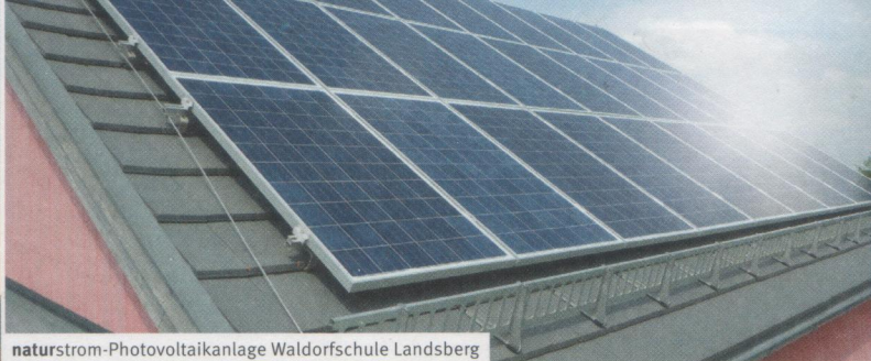
naturstrom-Photovoltaikanlage Waldorfschule Landsberg
